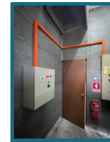
Unit 1-Ahu Room
